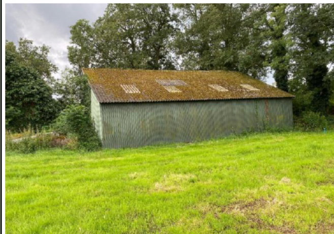
figuur 3: asbestdak van de kapschuur zonder dakgoot
