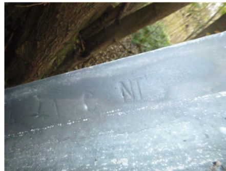
NT-golfplaat achterzijde kapschuur
