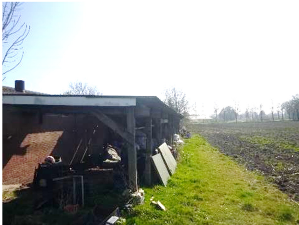
Overkapping schuur met druppelzone D
