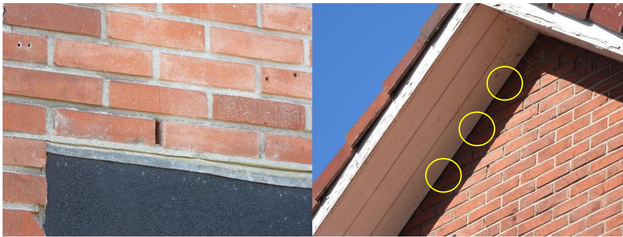
Foto links; Er zijn open stootvoegen in de buitengevels aanwezig. Foto rechts; er zijn kieren tussen de betimmering van het dak overstek en de buitengevels vastgesteld (gele cirkels).
