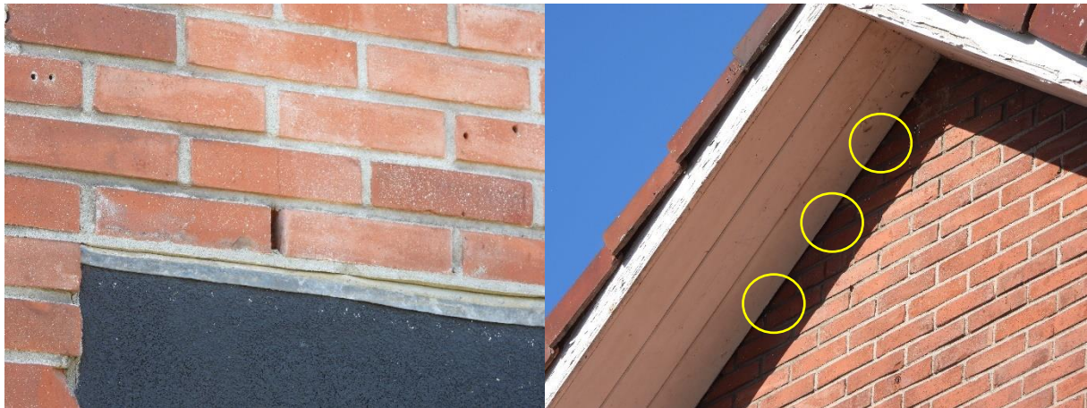
Foto links; Er zijn open stootvoegen in de buitengevels aanwezig. Foto rechts; er zijn kieren tussen de betimmering van het dak overstek en de buitengevels vastgesteld (gele cirkels).
