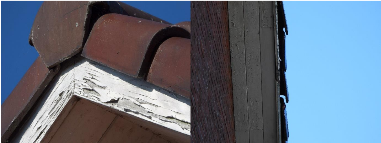
Foto links; onder de nok zijn openingen vastgesteld. Foto rechts; De gevelpannen sluiten niet nauw aan op de betimmering van het dak waardoor er openingen ontstaan.
