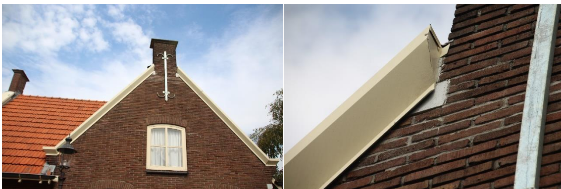
Brede windveer met opening aan de onderzijde. Dit biedt vleermuizen de kans een verblijfplaats te bezetten achter deze windveer.
