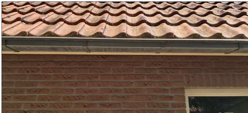
Vogelschroot onder de eerste rij dakpannen.
