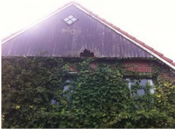
Houten gevelbetimmering met een opening; broedplaats van Kauwen.
